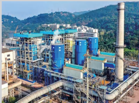
重慶鋼鐵自發電設備
