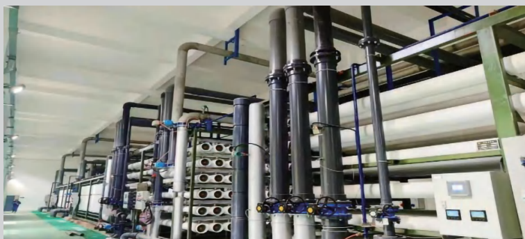
特殊廢水處理系統
